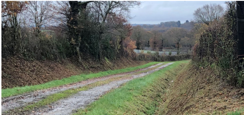
Fossé enherbé côté droit du chemin agricole, moitié amont du fossé (pente à 5,3 %)
